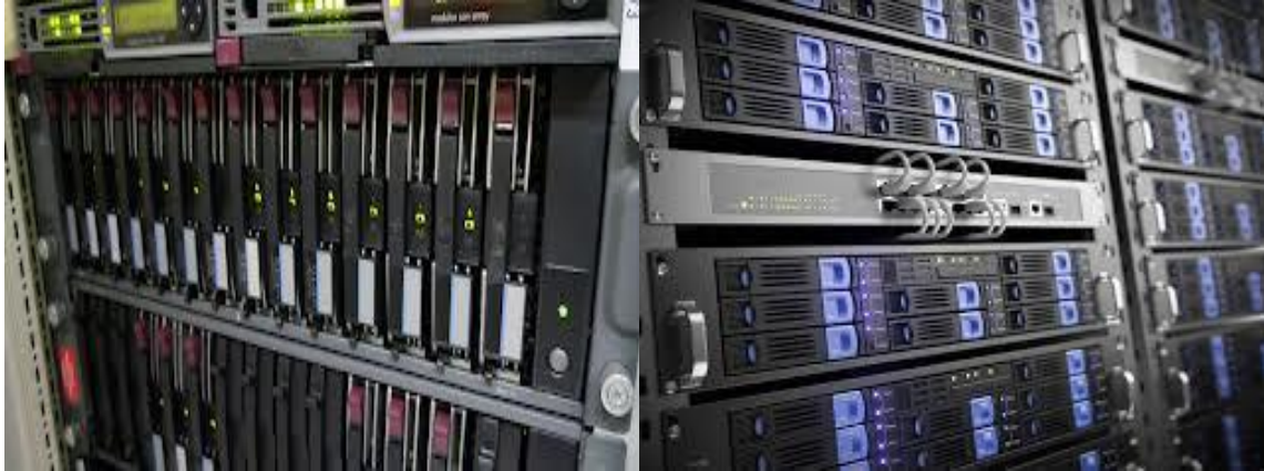
ภาพที่ 9 แสดงลักษณะของการติดตั้งเครื่องคอมพิวเตอร์แม่ข่ายแบบเบลด
